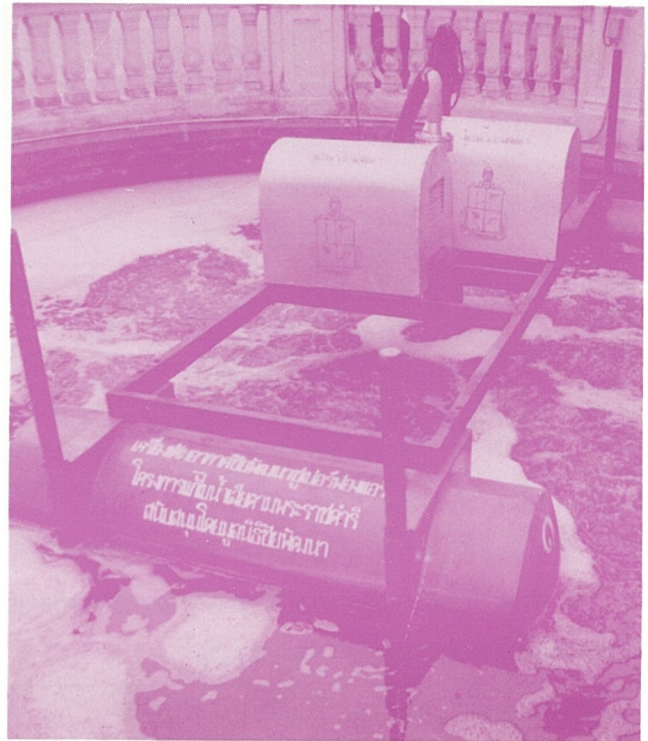
● เครื่องกลเติมอากาศระบบเป่าอากาศหมุนได้น้ำ
